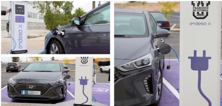
Ilustración 188. Cargadores de coche eléctricos instalados en la UFV.
