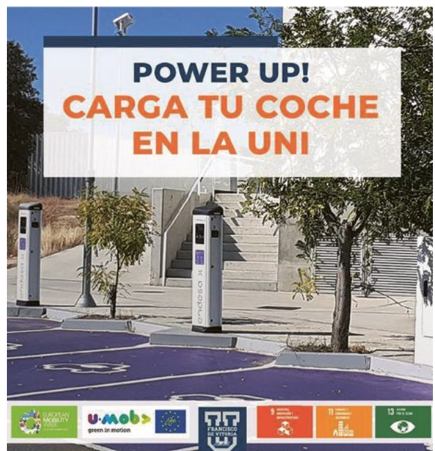
Ilustración 156. Cargadores de coches eléctricos en la UFV
